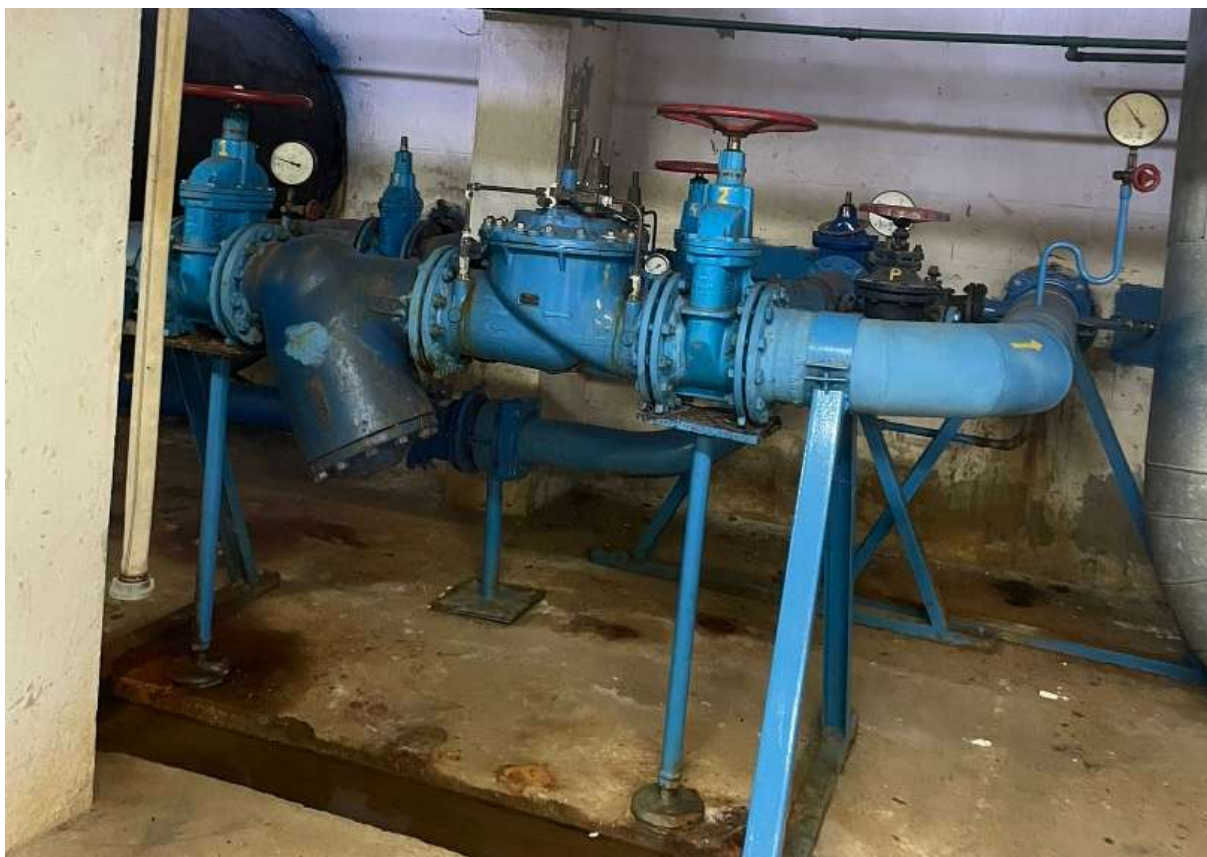
Węzeł reduktorów ciśnienia
