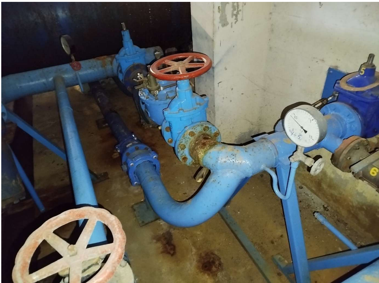
Węzeł reduktorów ciśnienia
