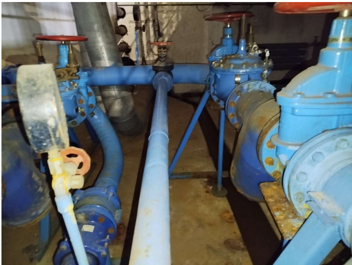
Węzeł reduktorów ciśnienia
